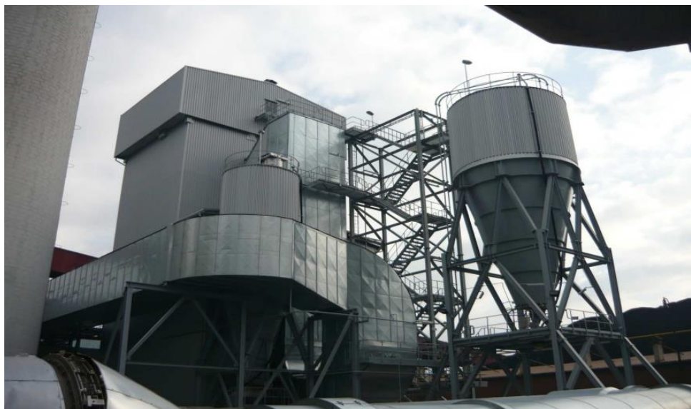
Obr. 95 Odsírovacie zariadenie v areáli Ť. T. a.s.
