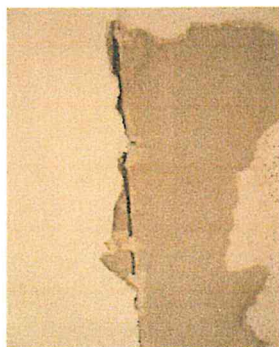
Budova bez súp. č. na p. č. 5396/8 - dispečing SAD - detail poškodenia stropu
