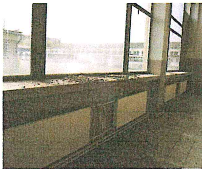
Budova bez súp. č. na p. č. 5396/8 - dispečing SAD - poškodenie obvod. muriva vplyvom zatekania vody
