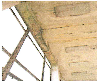
Budova bez súp. č. na p. č. 5396/8 - dispečing SAD - detail poškodenia stropu vplyvom zatekania vody
