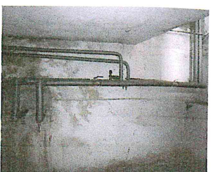
Budova bez súp. č. na p. č. 5396/8 - dispečing SAD - podzemné podlažie - prívod centrálného ÚK
